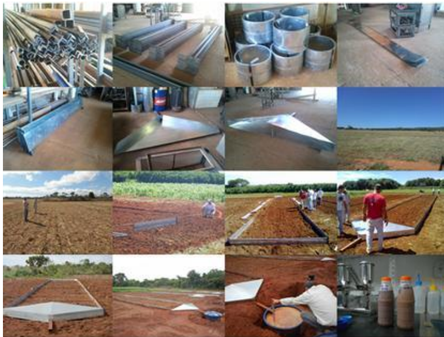
Figura 2. Etapas da construção das calhas de Wischmeier na Embrapa Cerrados, até o monitoramento da quantidade de água escoada e da coleta de amostras para análises da qualidade da água e da carga de sedimentos.
