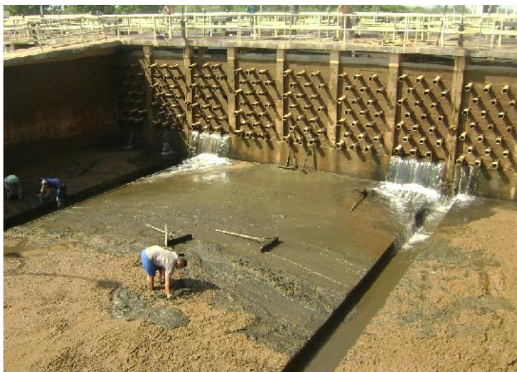
Figura 2. Lodo gerado no tanque de decantação da E.T.A de Imperatriz-MA
