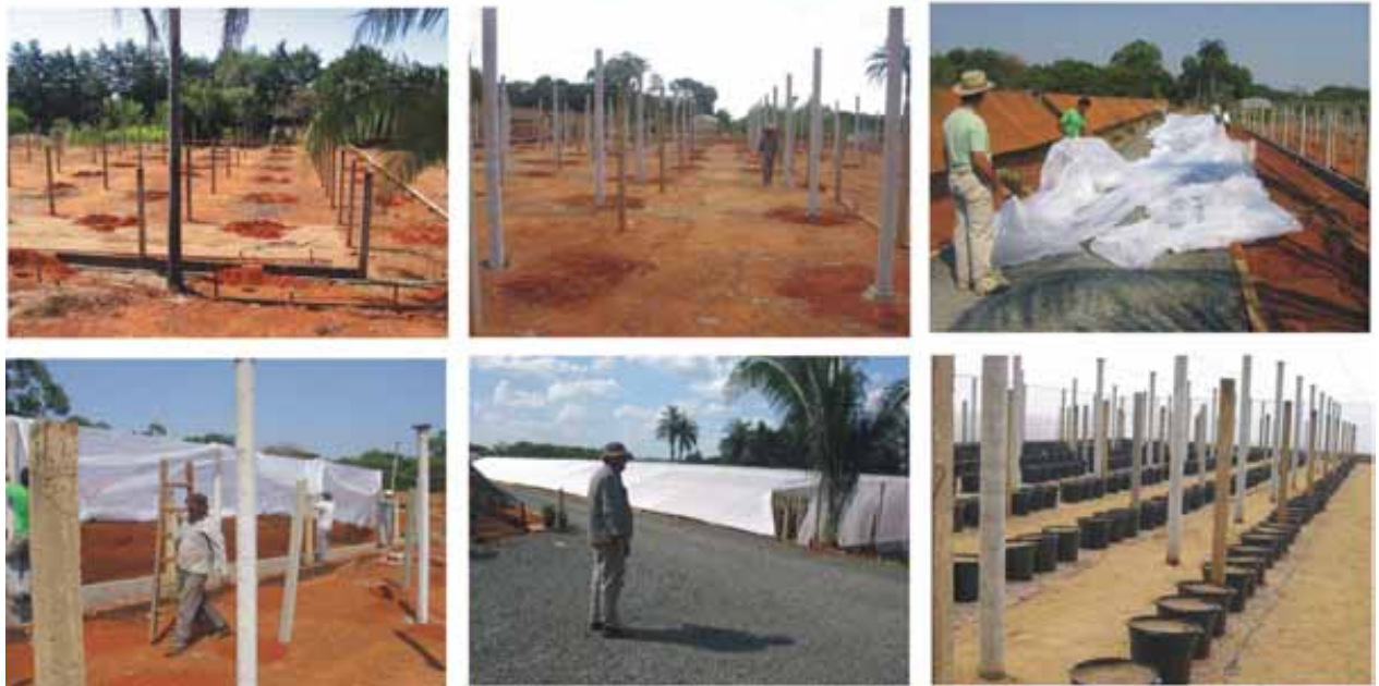
Figura 1. Algumas etapas da construção da casa telada que vai abrigar o Banco de Germoplasma "Flor da Paixão". Fotos: Embrapa Cerrados
